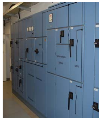
Ext. Handbypass und Schaltanlage zur unterbrechungsfreien Umschaltung für Service und Wartung
