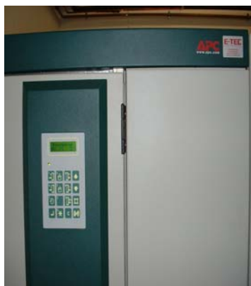
USV- Anlage 160kW red. Mit LAN Anschluss, Überwachung und Server „shut down“ über das Netzwerk TCP/IP.
